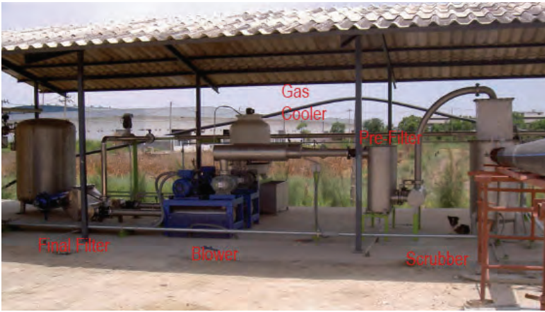
ระบบทำความสะอาดก๊าซก่อนนำไปเป็นเชื้อเพลิงเพื่อผลิตกระแสไฟฟ้า
